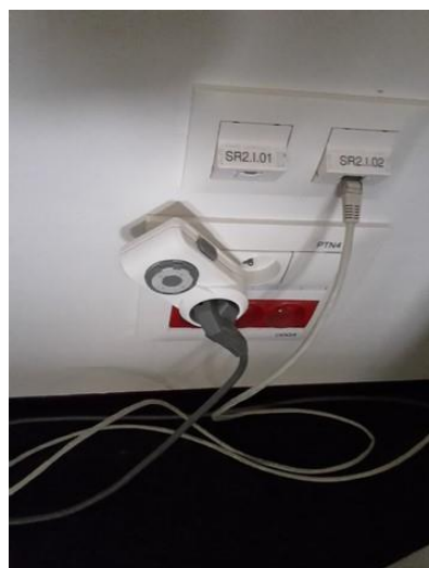
Installation de prises programmables sur les imprimantes
